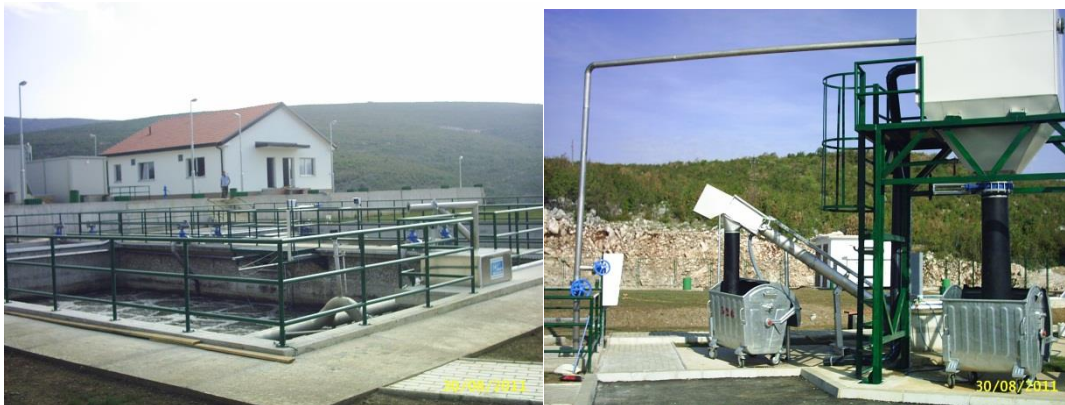
Слика 24 : - Изграђено постројење у Билећи
